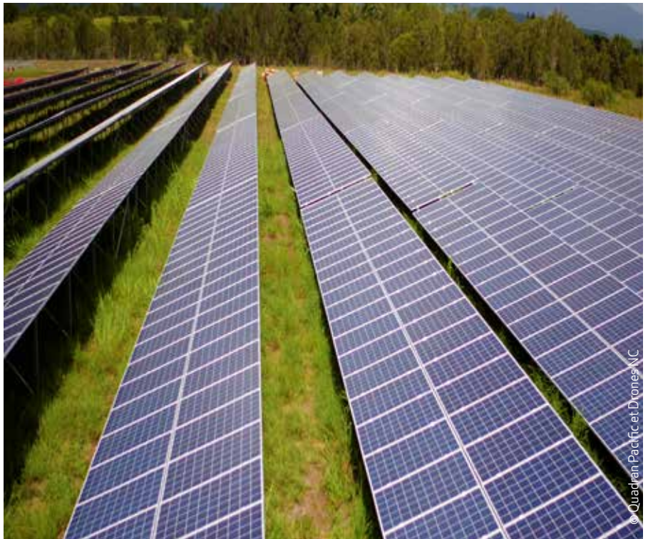
Avec une puissance de 12 mégawatts, Hélios Boulouparis va alimenter 5 400 foyers.
