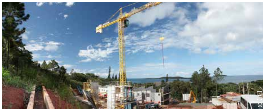
Une zone de tri des déchets signalisée sur le chantier de construction du lycée du Mont-Dore.
